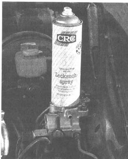
Fehlersuche, die erste: Ein undichter Steuerkolben ist (manchmal) mit Lecksuchspray zu entlarven
